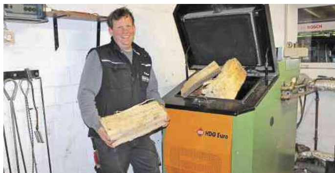
Hauke Möller beim Befeuern eines Stückholzkessels
